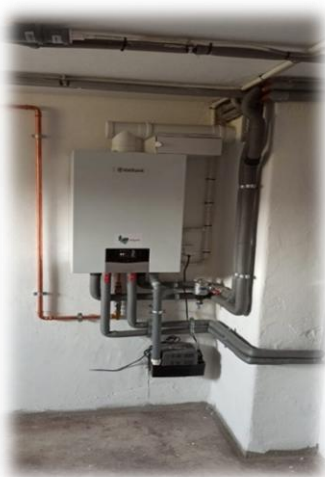
Widok na kotłownię w PP w Zawadzie
