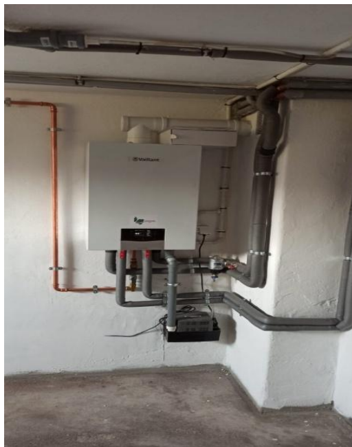
Widok na kotłownię w PP w Zawadzkie
