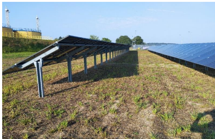
Instalacja fotowoltaiczna na oczyszczalni ścieków w Kotorzu Małym
